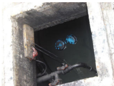
Figura 7: Tanque subterrâneo para captação dos efluentes líquidos para tratamento (foto: Kelli C.A.S.)
